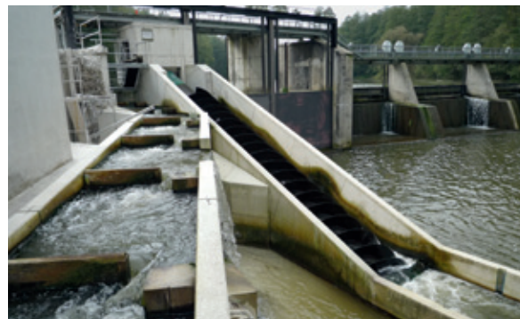
Centrale idroelettrica che sfrutta il deflusso residuale 14
